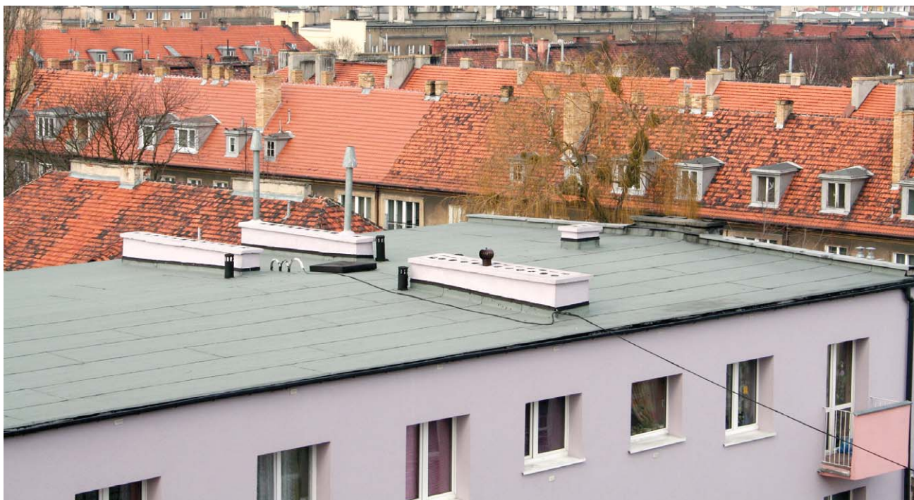
Należy dbać o właściwy stan techniczny przewodów dymowych, spalinowych i wentylacyjnych.
