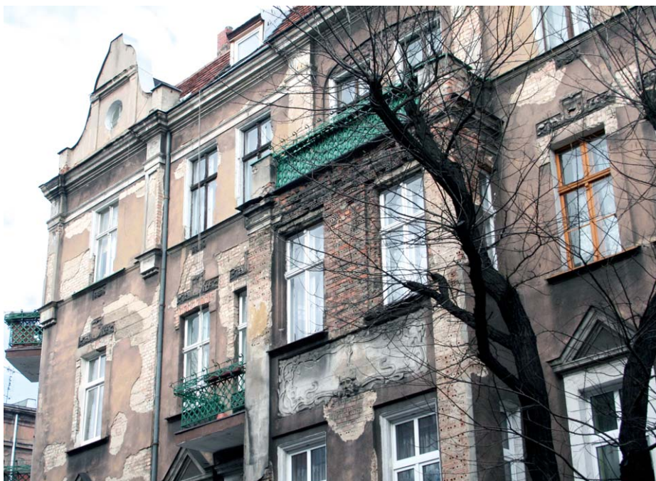
Przykład na brak dbałości o elewację zewnętrzną.
