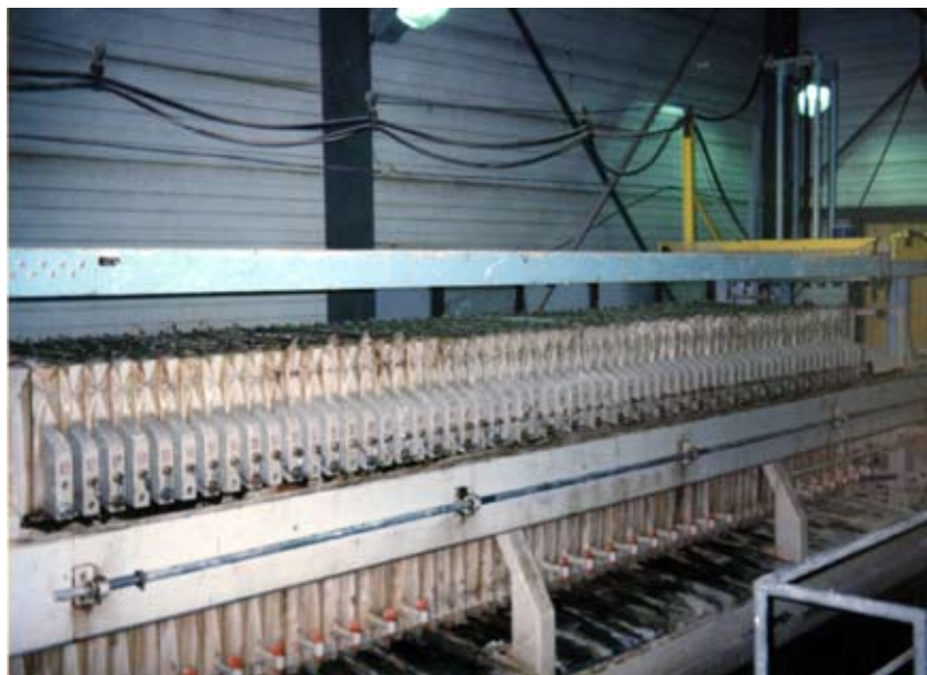
Automatycznie sterowana komorowo-membranowa prasa filtracyjna podczas cyklu filtracyjnego, pracująca w cukrowni we Wschowie i odwadniająca osady defekosaturacyjne.
