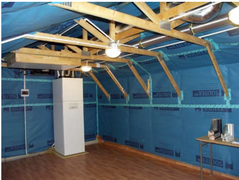
Wnętrze Domu Pasywnego z kompaktową centralą grzewczą.
