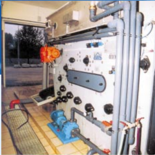
W Płocku od szeregu lat stosuje się mechaniczne odwadnianie osadów pokoagulacyjnych
