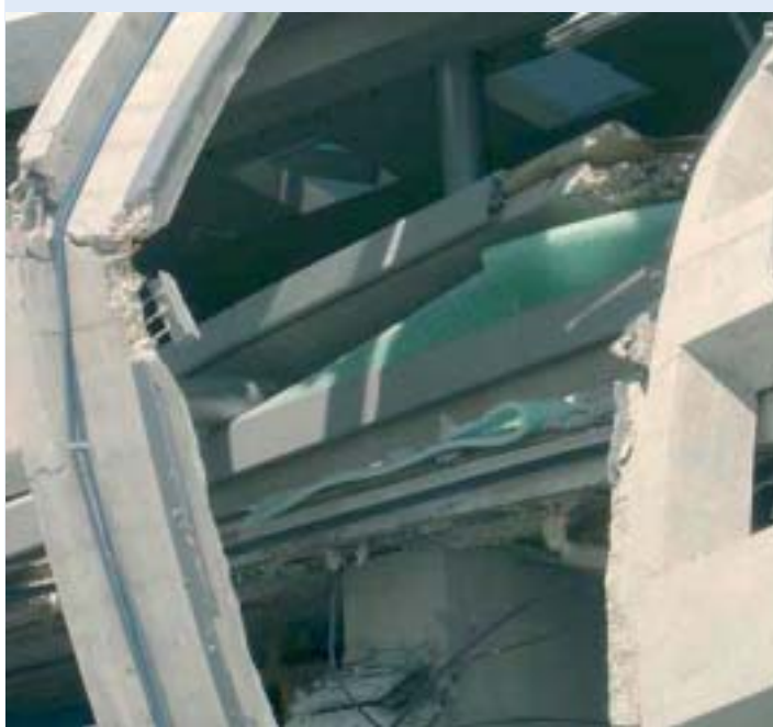
Rys. 12-13. Przykłady zniszczeń lupiny nośnej [1]
