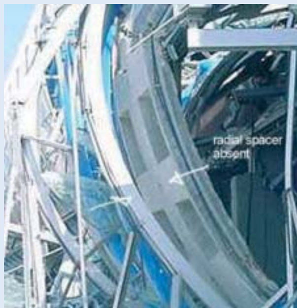
Rys. 11. Zniszczona łupina w strefie brakujących słupków [4]
