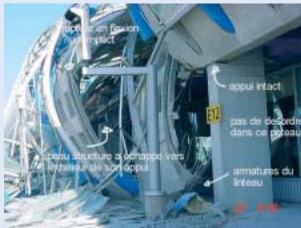
Rys. 10. Strefa zniszczenia od strony południowej [4]
