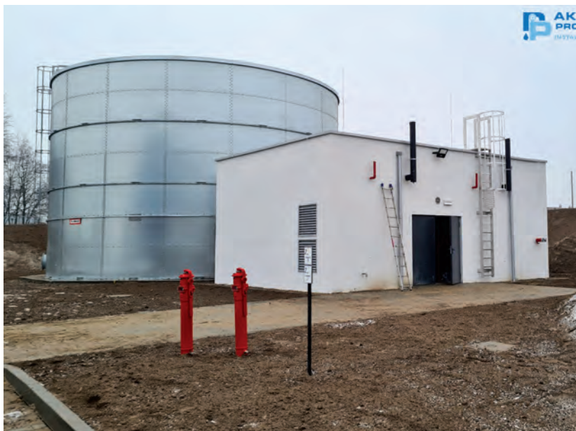
Źródło wody do zasilania sieci hydrantów zewnętrznych oraz instalacji tryskaczowej. Pompownia przeciwpożarowa i zbiornika zapasu wody o pojemności 1000 m 3 . Źródło: Archiwum prywatne autora
