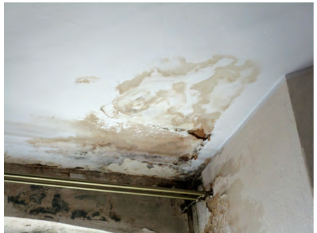
Zawilgocenia ścian i stropów. Fot. PINB Poznań
