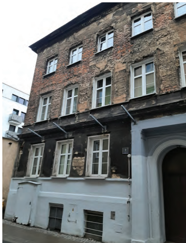
Spękania i odparzenia tynków. Fot. PINB Poznań
