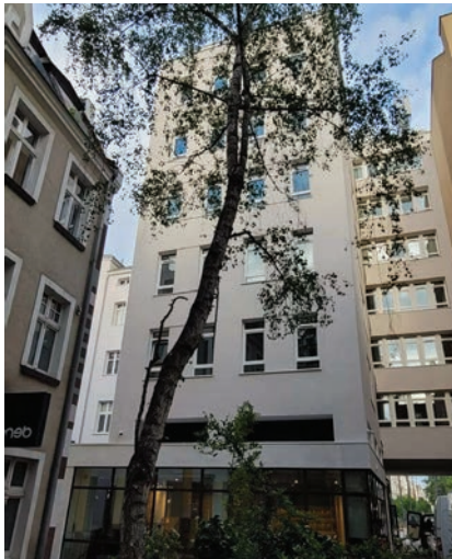
Zdjęcie nr 3. Widok na elewację budynku od strony wewnętrznej przed i po pracach nadbudowy. Źródło [1] – fot. P. Marciniak
